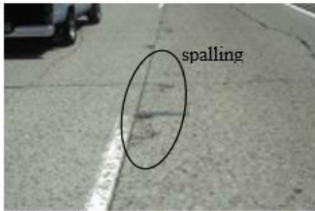
(a) Longitudinal spalling
