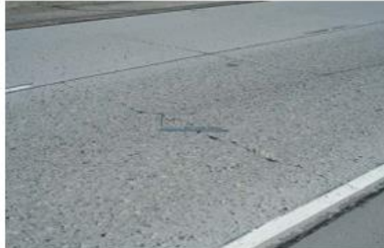
(d) Transverse cracking
